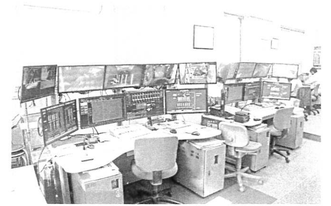
各プラントの計量操作盤を「LIBRA a」の最新機種に更新
